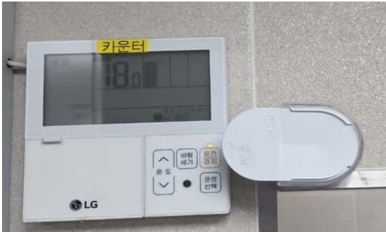
매장 내 컨트롤러 설치 사진
