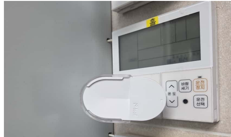
매장 내 컨트롤러 설치 사진(2)
